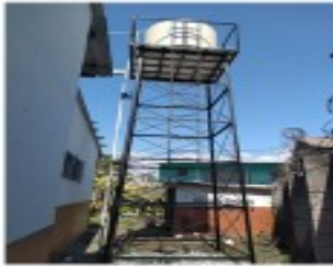
Tanque de Agua en Metallo
