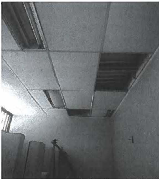
FALTAN LOSETAS EN EL CIELO FALSO
