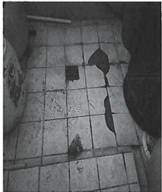
PISO EN MALAS CONDICIONES
