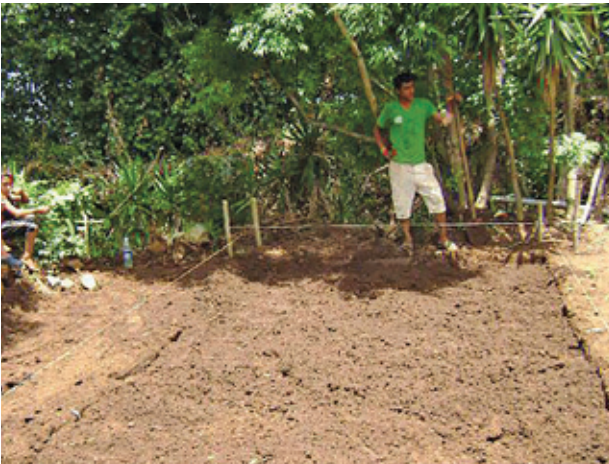
Primeros pasos de preparación de la losa, donde se montarán los tanques del Sistema de Capatación de Agua lluvia Techo y Agua .
