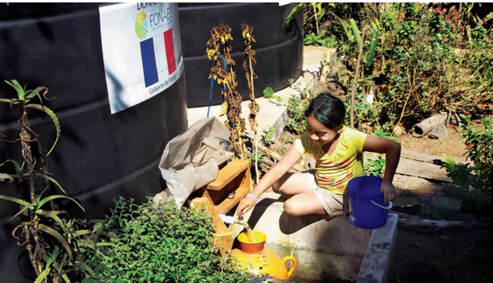
Niña sacando agua del sistema Techo y Agua en el proyecto en el Cantón Ochupse Arriba, III Fase.
