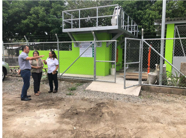
Ilustración 10. Sistema de tratamiento de aguas residuales construido en el rastro de Apopa, Apopa, San Salvador. Octubre de 2019
