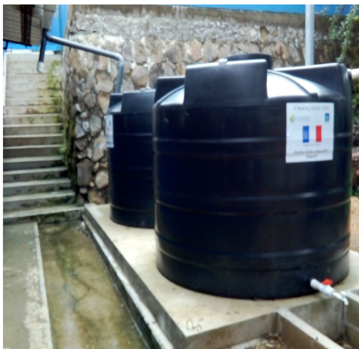
Ilustración 2. Sistema instalado en centro escolar cantón San Benito, municipio San Antonio de la Cruz departamento de Chalatenango.
