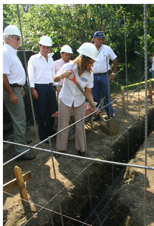
Colocación de la primera piedra para la construcción de 35 Viviendas, Comunidad María Victoria, municipio de Huizúcar, Componente Subsidios para la Reconstrucción, Fideicomiso “Construyendo un Sueño”
