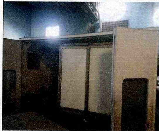
• Cabina de presurizado pintura
