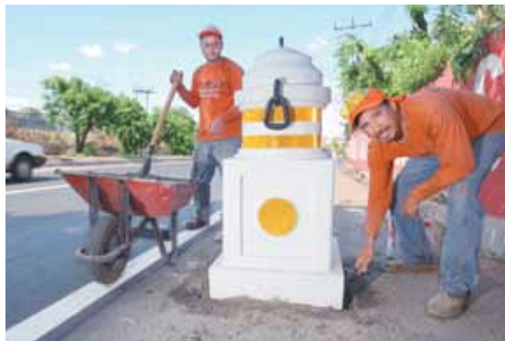
Señalización horizontal (demarcación de línea amarilla discontinua) en carretera a Santa Ana.
