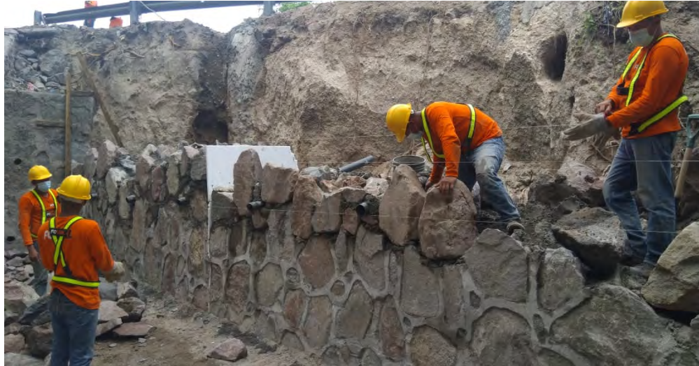
FOVIAL atendió cárcava en carretera al Turicentro de Apulo.
