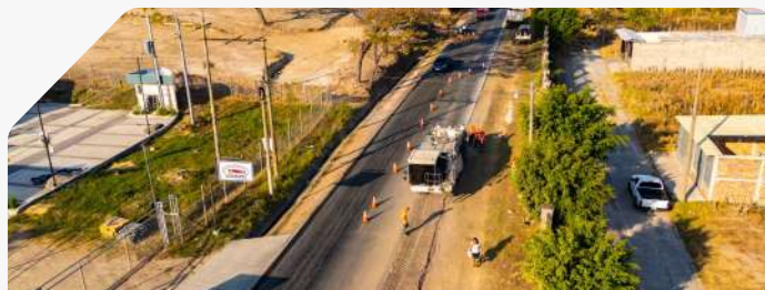
FOVIAL da inicio al mantenimiento periódico de la carretera Ilobasco – San Isidro – Sensuntepeque, Cabañas Pág.10
