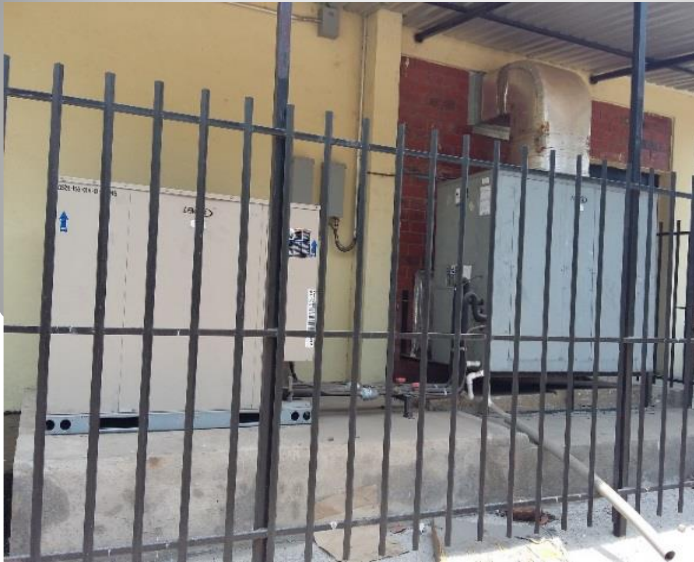
CENTRAL DE AIRE ACONDICI ONA
