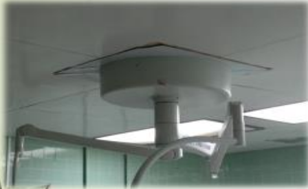
Antes Daños en cielo falso en Quirófanos 1 y 2
