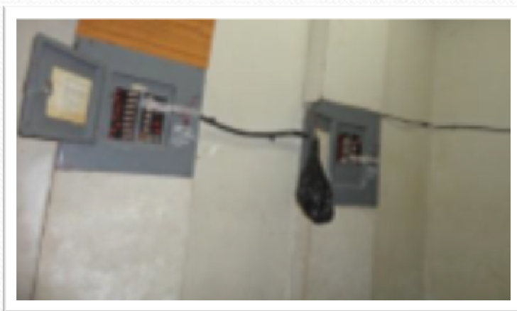
Antes: líneas de tablero están conectadas fuera de norma
