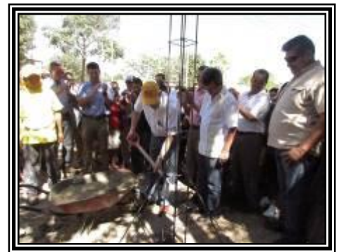
Entregado el Informe Legal por parte del ILP, el VMVDU continuó con el inicio de obras de construcción del Proyecto "El Castaño", en el municipio de Soyapango.
