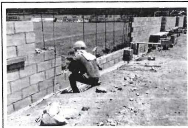
065 Cseguimiento dela colocacion de manposteria de bloque de concreto 10x20x40 en muro perimetral de eje1A
