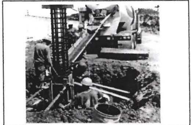
058 Colado de concreto F'C 210 kg/cm 2 en pedestal de columna tipo C-3 en eje 4
