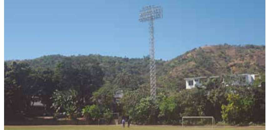
Instalación de luminarias en el Complejo Deportivo Santa Ana (Exfinca Modelo) tuvo una inversión de $69,874.77.
