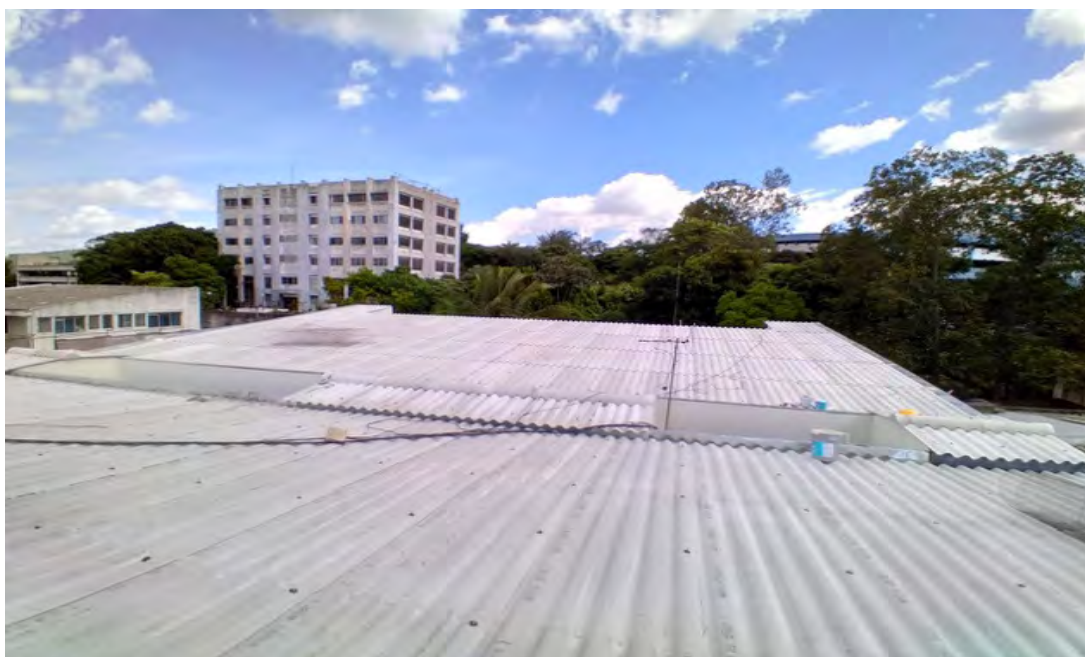
DESPUÉS: Desmontaje de láminas de Asbesto cemento y cambio por láminas de duralit
