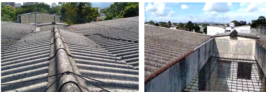
ANTES: Lamina de Asbesto cemento y lamina troquelada.
