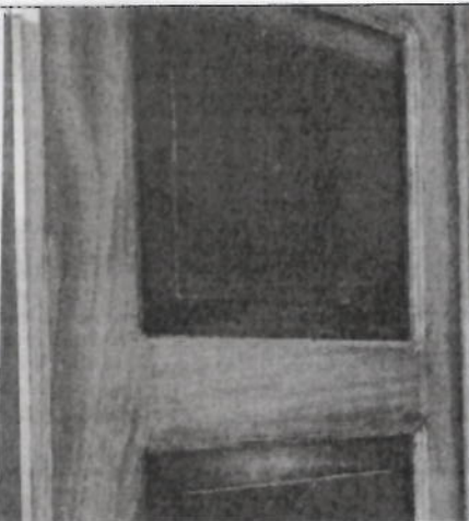
PUERTA DETERIORADA POR EL BARNIZ
