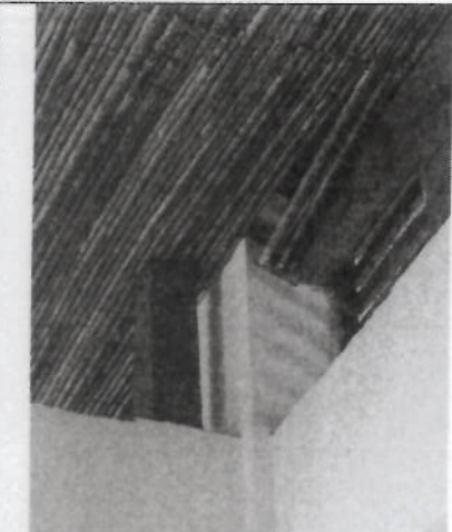
CIELO FALSO DE VARA DE CASTILLA
