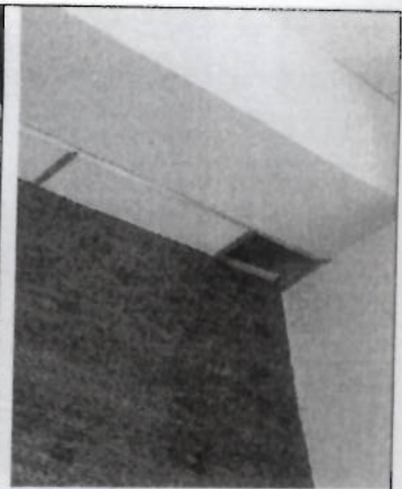
CIELO FALSO MOVIDO DEL PERFILADO
