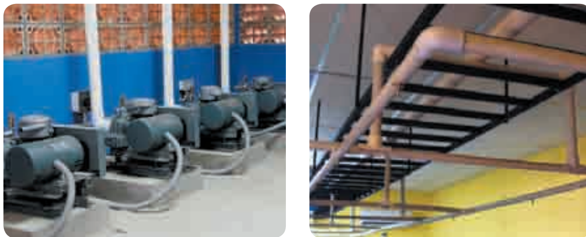
Fig. 8 Sopladores y tuberías de aireación.
