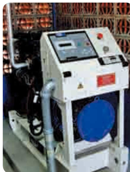
Fig. 9 Generador de emergencia 20 KVA
