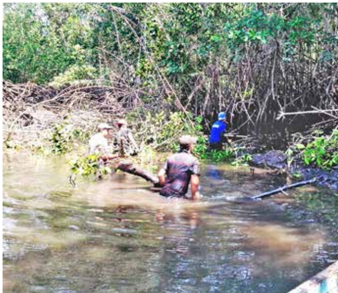
Río con cauce azolvado.
