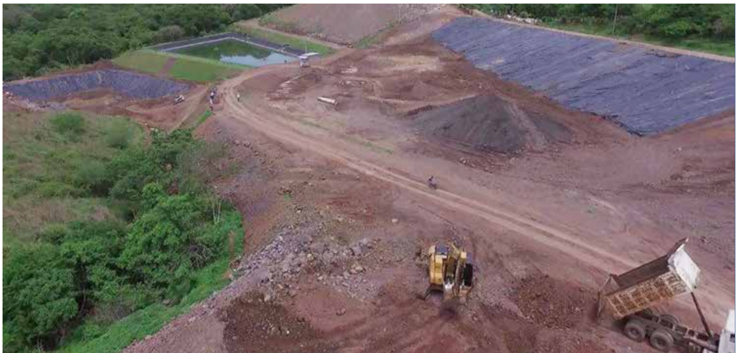
Relleno sanitario ubicado al norte de La Unión
