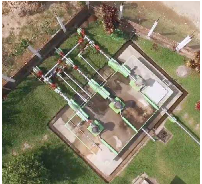
Planta de bombeo de ACOSAMA que abastece de agua a los habitantes de San Pedro Perulapán. Este proyecto fue galardonado el Día Mundial del Agua
