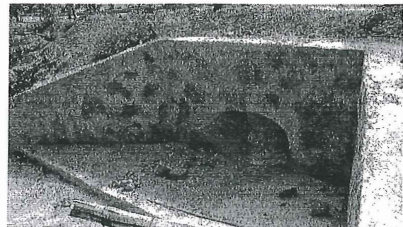
Disipador de energía.
