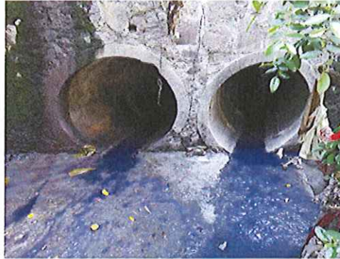
Fotografía 9. Vista de las tuberías (bóveda) donde se conducen las aguas de la quebrada de interés identificándose la misma coloración púrpura en este sitio.
