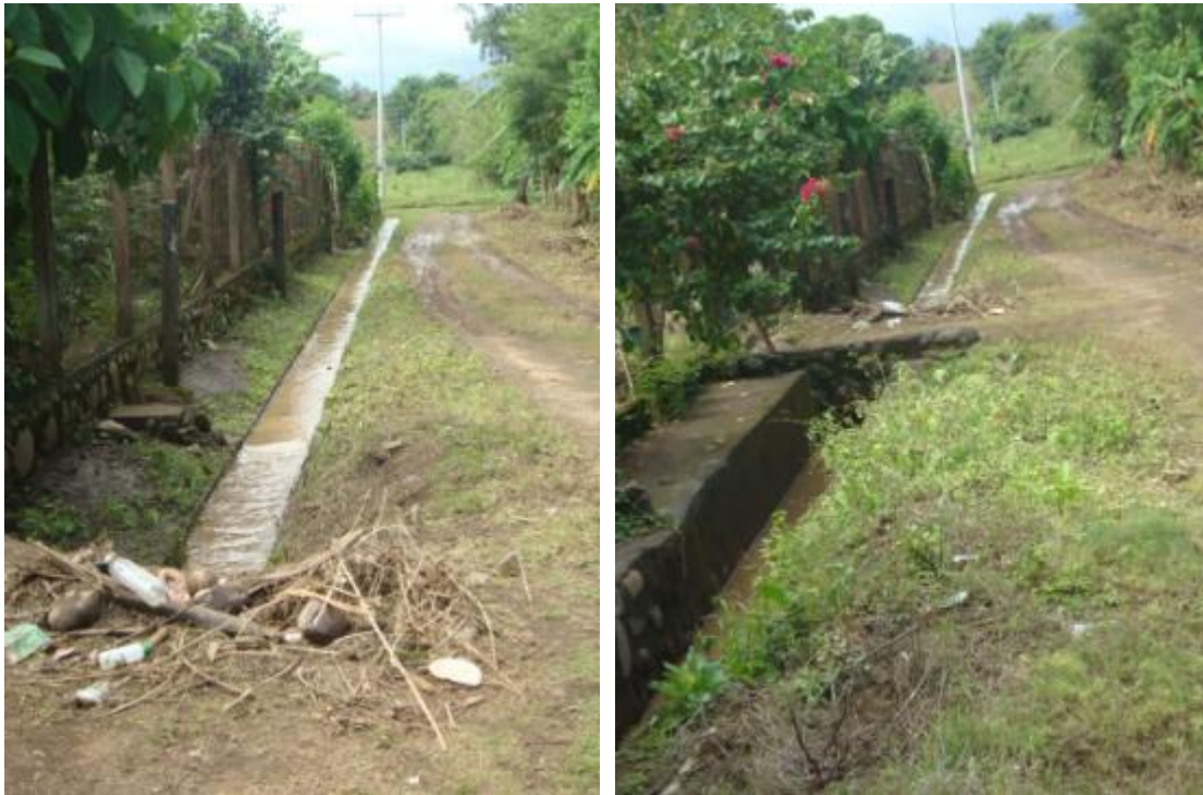
Foto 3 y 4. Ubicación de Obra de Mitigación
