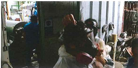
Foto 1: Preparación con equipo de protección respiratoria previo al ingreso al área de funcionamiento del sistema de refrigeración que presentó la fuga de amoníaco. En segundo plano, evaporador de amoníaco que presentó el daño.
