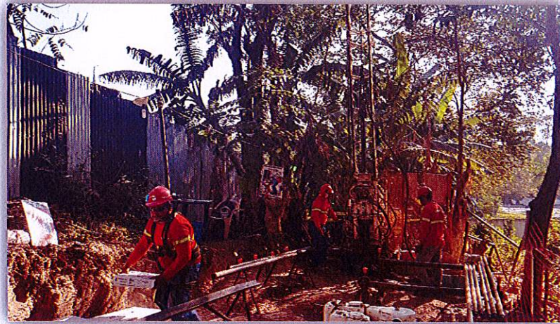
Sondeo R-01 ubicado contiguo a las instalaciones provisionales de la construcción contigua.
