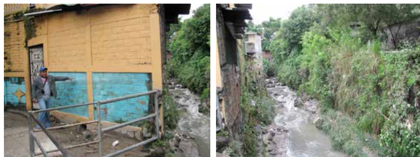
Figura 84. Nivel alcanzado en evento Agatha (mayo de 2010) en colonia Las Mercedes (Mejicanos) Fuente: MARN
