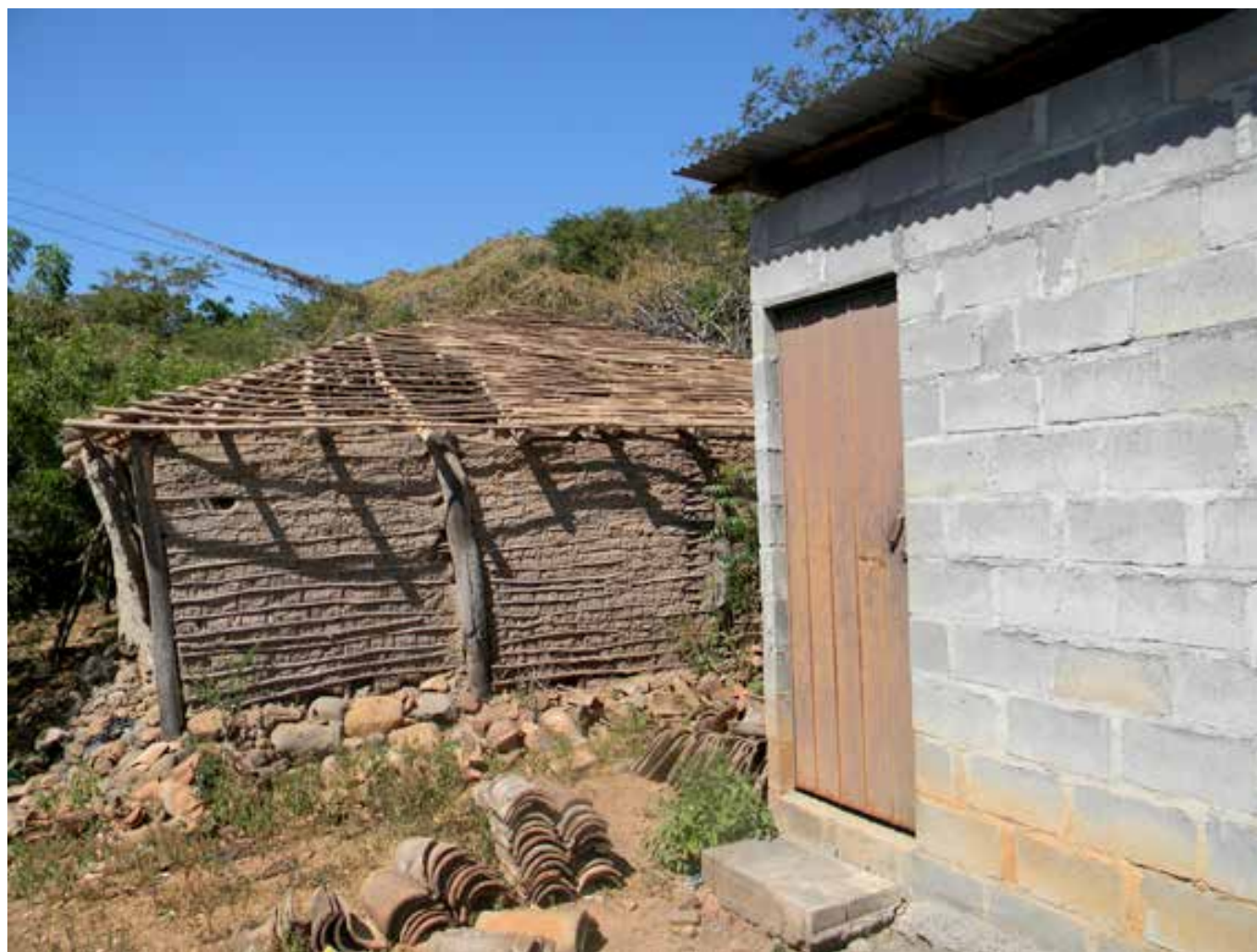
Figura 137. Daños observados en viviendas de adobe y mampostería reforzada durante enjambre sísmico en El Carmen, La Unión, noviembre - diciembre del 2011 (Magnitud máxima Mw 4.9) 66
