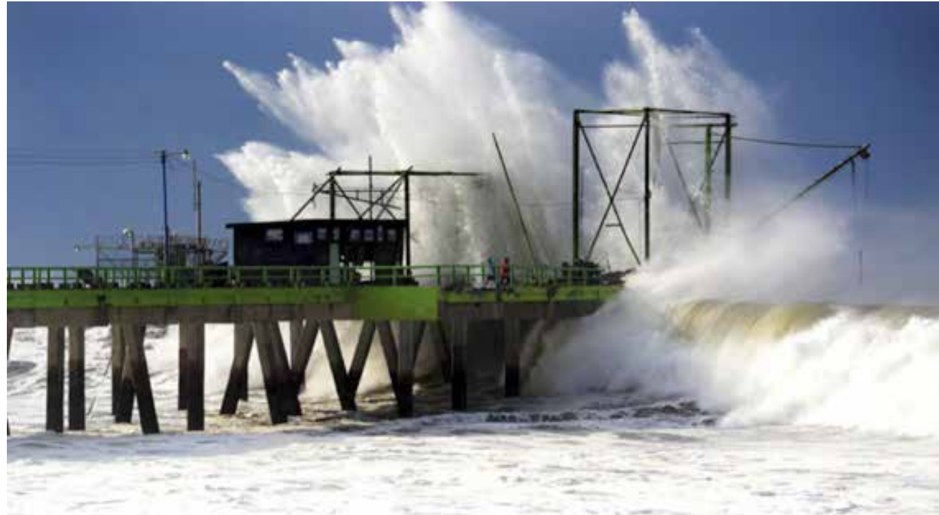
Figura 106. Fuerte oleaje impactando la estructura del muelle de La Libertad entre el 2 - 4 de mayo de 2015 (Foto: Mario Amaya) Fuente: Elaboración propia MARN
