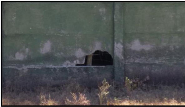
Figura 28. Daño en el muro de BAES, en la zona de drenajes (Diciembre 2015).
