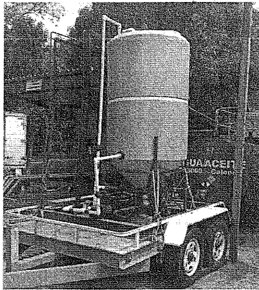
Vista de la parte del sistema de tratamiento de aguas residuales que suministra los coagulantes y floculantes.
