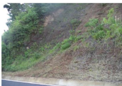
Fotografía 24. Zona de deslizamiento con obras de mitigación carretera Comasagua- Talnique. Fuente: GOA
