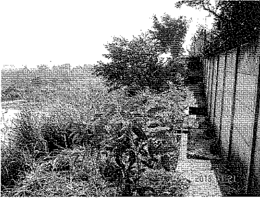
Foto #1 Cajas de recolección de agua y arborización en Talud.
