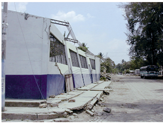
Dstrucción de Escuela a causa del terremoto, 2001 Verapaz, San Vicente, SNET-MARN
