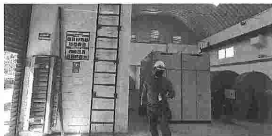
Fotografía 1. Señalización de seguridad industrial observada.
