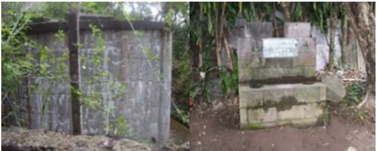
ILUSTRACIÓN 44: SISTEMAS DE CAPTACIÓN DE AGUA LLUVIA POR ESCURRIMIENTO Y ALCANTARERA
