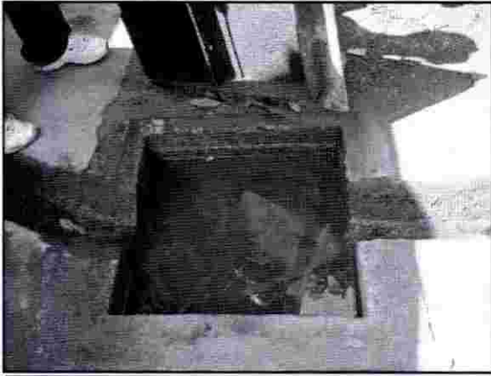
Fotografía 5. Caja separadora de grasas y aceites ubicada en área de talleres.
