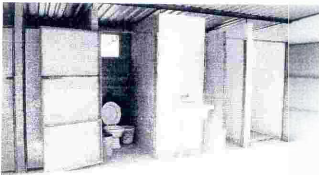
Bateria de sanitarios
