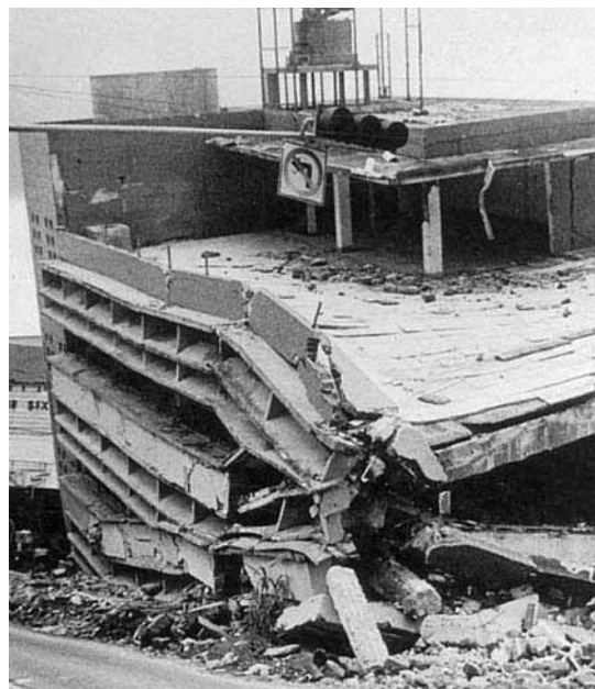
▶ Edificio Rubén Darío destruido por el terremoto de 1986. Foto propiedad del Museo de la Palabra y de la Imagen.
