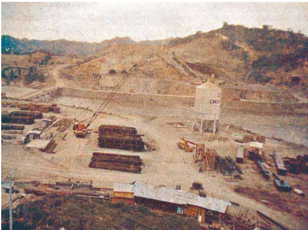
► Panorámica de los trabajos de construcción de la presa hidroeléctrica del Cerrón Grande. Tomado de Historia de El Salvador . Tomo II. San Salvador: Ministerio de Educación, 1994. p. 232.
