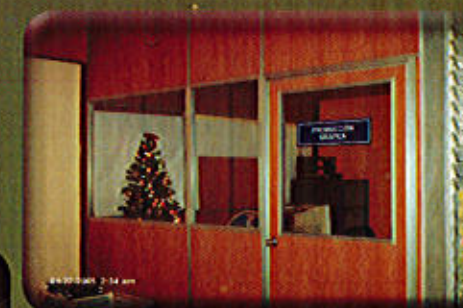
Contrucción de oficinas de Producción Gráfica (foto arriba) y trabajos de remodelación en Administración.
