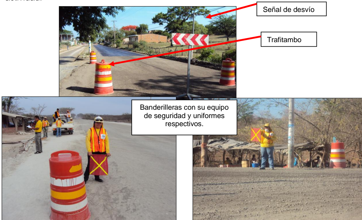
Figura 7. Ejemplo de señalización y control del tráfico durante las actividades de construcción.
