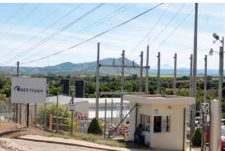
Foto 4. Subestación AES Nejapa, en el relleno sanitario de MIDES. Fuente: Marielos Marín, 2012.
