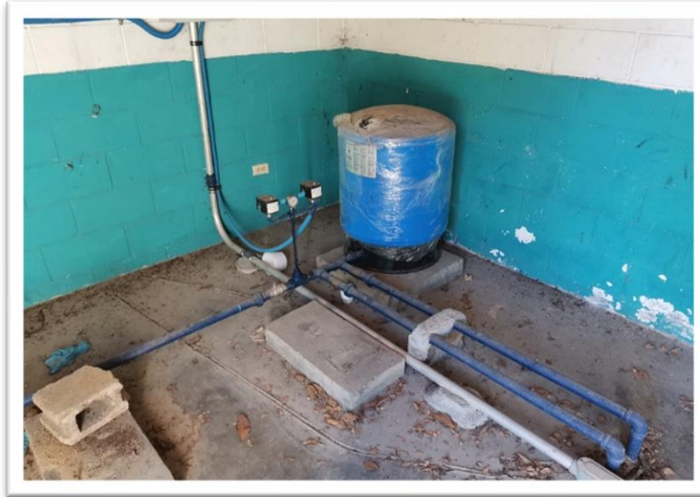
Imagen 4. Equipo de bombeo existente en cisterna
