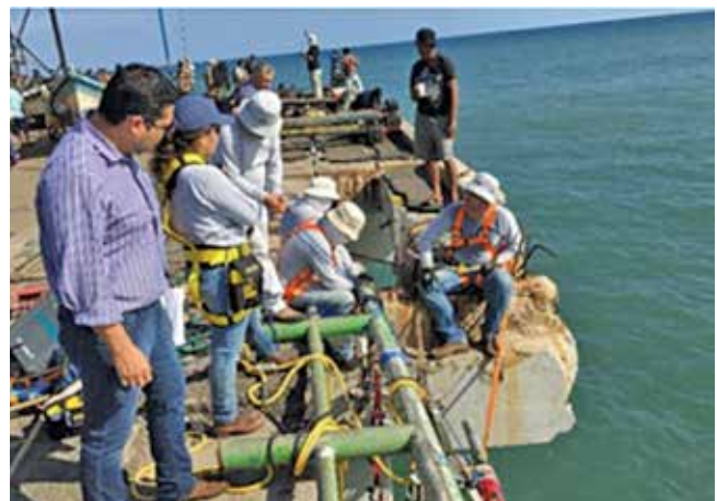
Seguimiento a los trabajos del ISCYC como parte del diagnóstico estructural del muelle del Puerto de La Libertad. 18 de julio de 2016.
