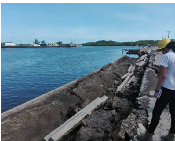
Revisión de los daños causados en el muelle por el evento extraordinario de crecimiento de marea con el fin de realizar ajustes al diseño y sistema constructivo de las mejoras. 11 de agosto de 2017.
