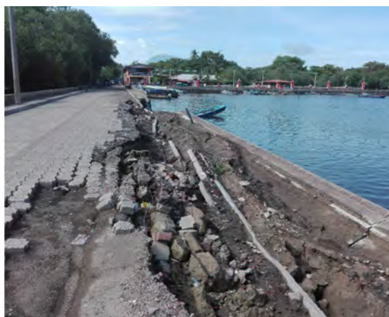
Daños en el muelle existente a ser reparados como parte de las mejoras y adecuación turística. 11 de agosto de 2017.
