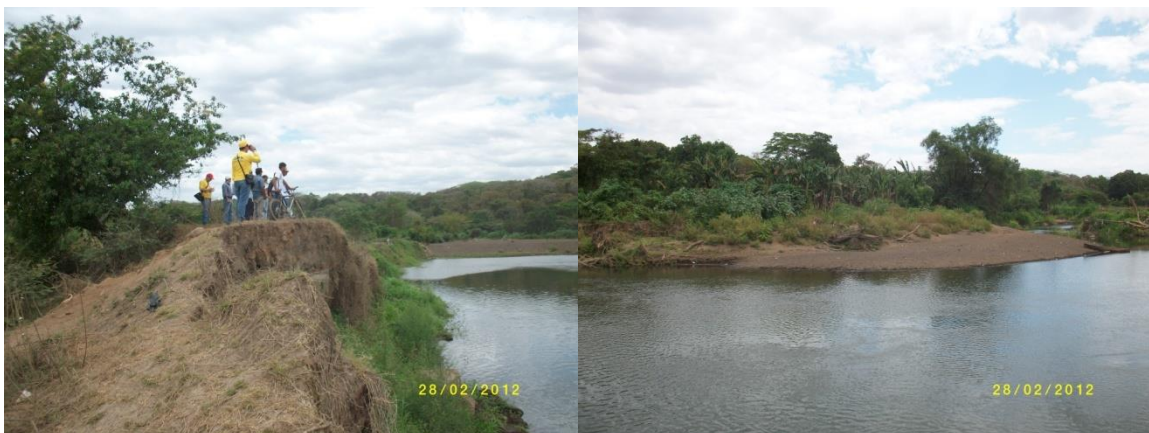
Fotos 5 y 6. Sitio de mayor longitud de daños estructural de la borda, son cerca de 170 m de borda dañada; desde este punto, el desborde del río afecta principalmente a las comunidades de El Limón, El Icazo, Botoncillo I y II.
