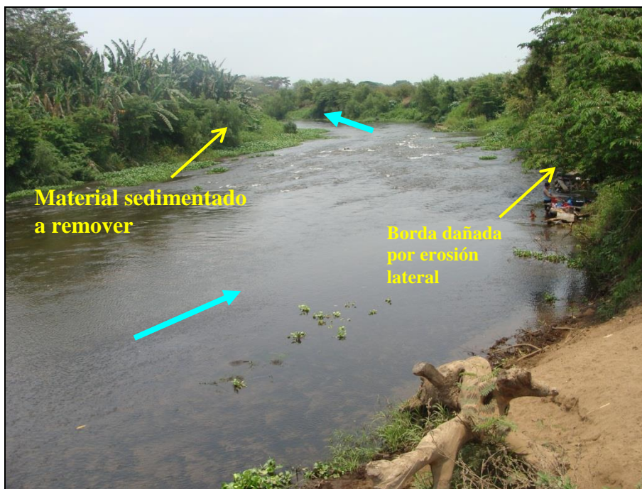
Fotografía 4: Material depositado en cauce y erosión lateral en borda.
