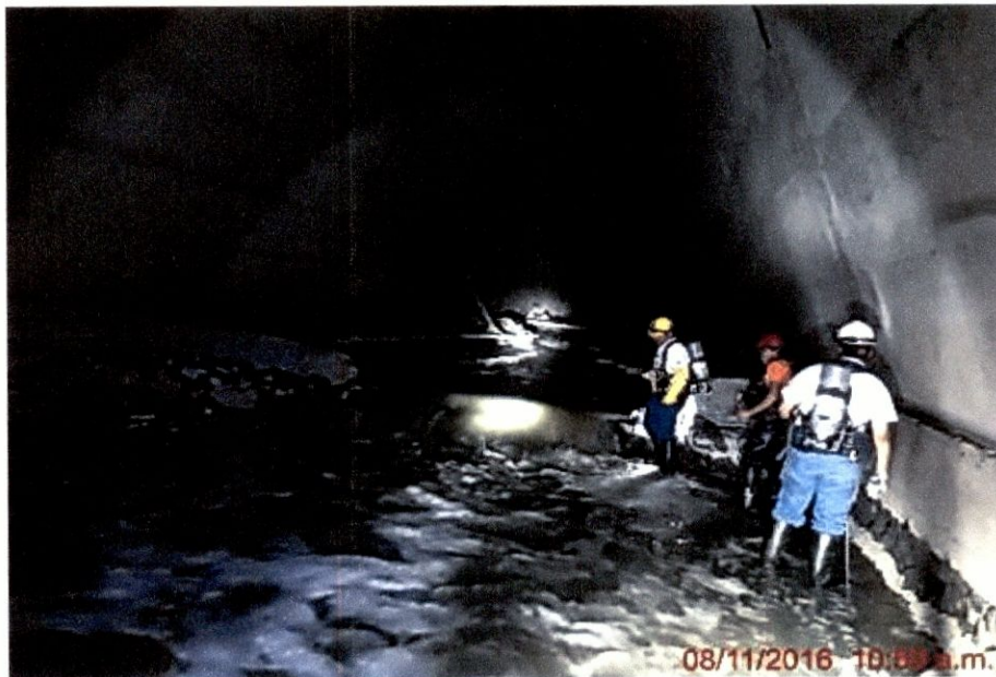
Fotografía No. 2. Cama de agua dañada en sector de Senda No 8.
