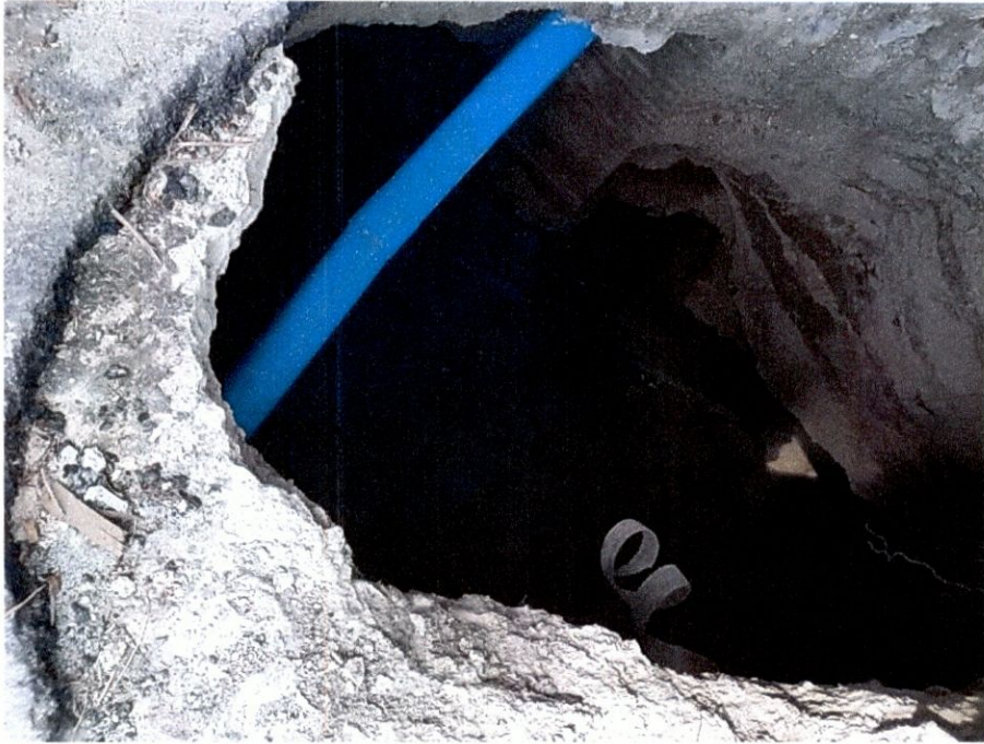
Fotografía 1. Vista interior de hueco en sector de Senda No 8.
