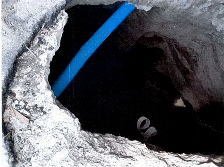
Fotografía No. 1. Vista interior de hueco en sector de Senda No 8 Residencial Brisas de San Francisco.
