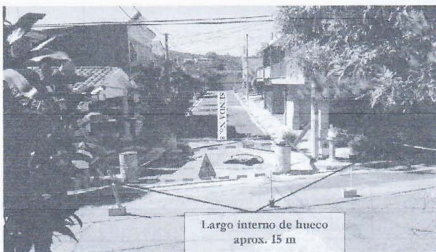
Figura 2. Vista de hundimiento en inicio de Senda No.8 y esquema de oquedad interna
