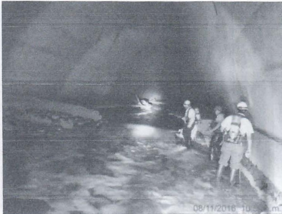
Fotografía N°24. Caída de Cama Hidráulica de altura de 1 m. dañada (estacionamiento 0+345).
