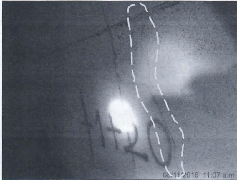
Fotografía N°18. Presencia de grietas en paredes laterales, entre estaciones 1+00 y 1+60
