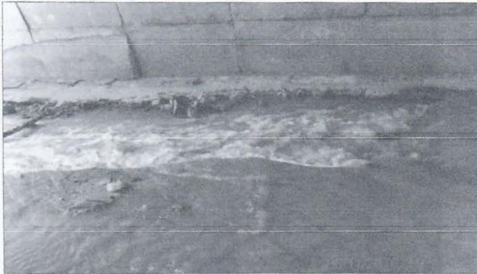
Fotografía N°17. Pérdida de cama hidráulica en margen derecho de Bóveda (estacionamiento 0+445).
