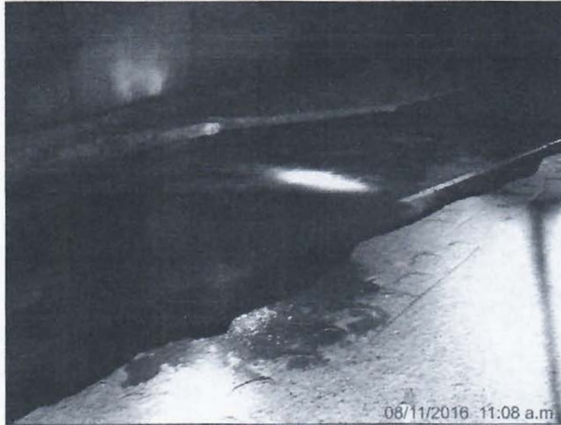
Fotografía N°20. Socavacion en estacion 1 + 20 (sector de senda No 8).
