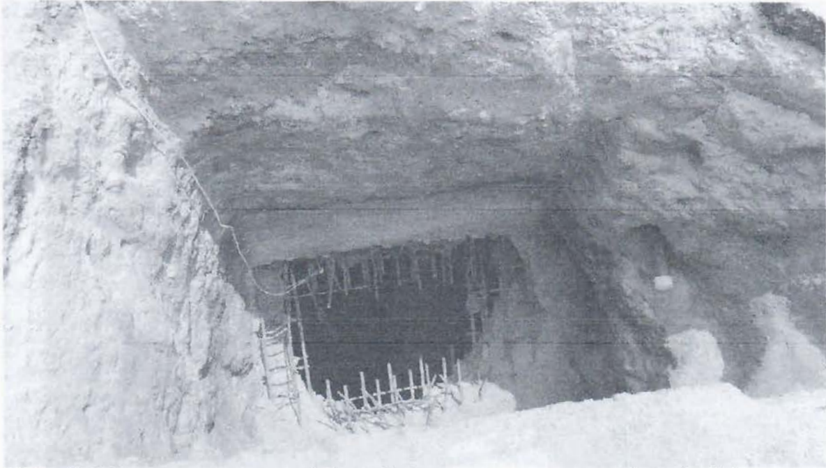
Fotografía 2. Vista interna de ventana respiradero realizada en costillas de la bóveda contiguo a hundimiento y pozo de aguas negras
