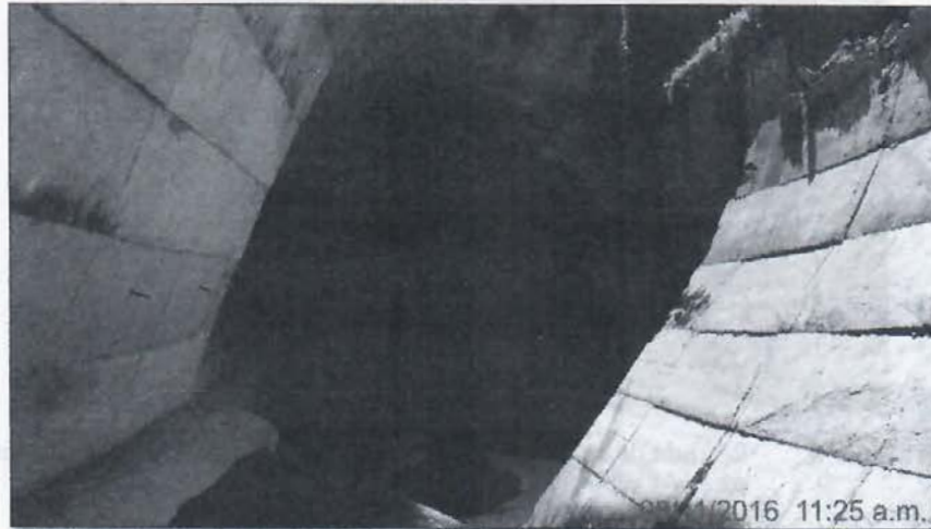
Fotografía N°6. Vista hacia aguas abajo de punto de colapso (estacionamiento 0+00).
