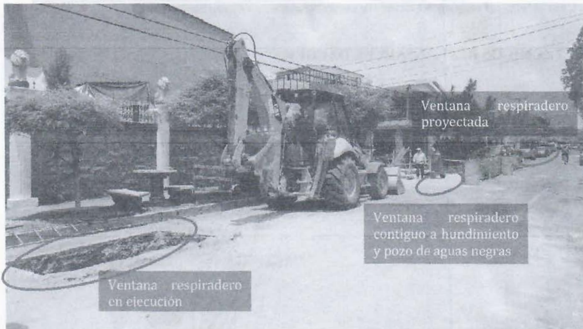
Fotografía 3. Ubicación de ventanas respiraderos separadas por 20 m entre sí
