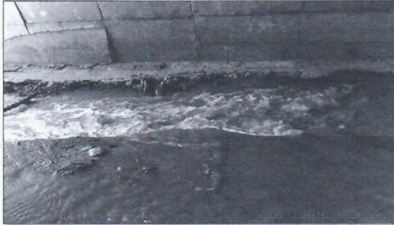
Fotografía N°7. Pérdida de cama hidrualica en margen derecho de boveda (estacionamiento 0+00).
