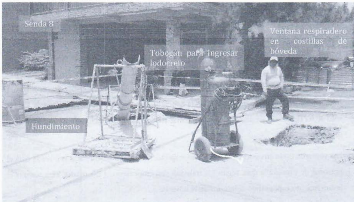
Fotografía 1. Ventana respiradero contiguo a hundimiento y pozo de aguas negras para facilitar el ingreso de materiales y equipo a la bóveda. Además, tobogán para realizar relleno de lodocreto en hundimiento.
