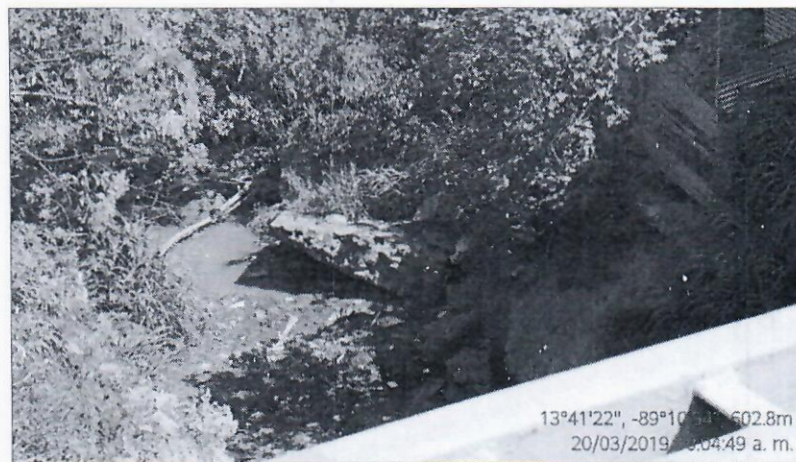
Fotografía N° 10. Presencia de porción de muro de retención colapsada, en margen derecha de quebrada, aguas abajo.
