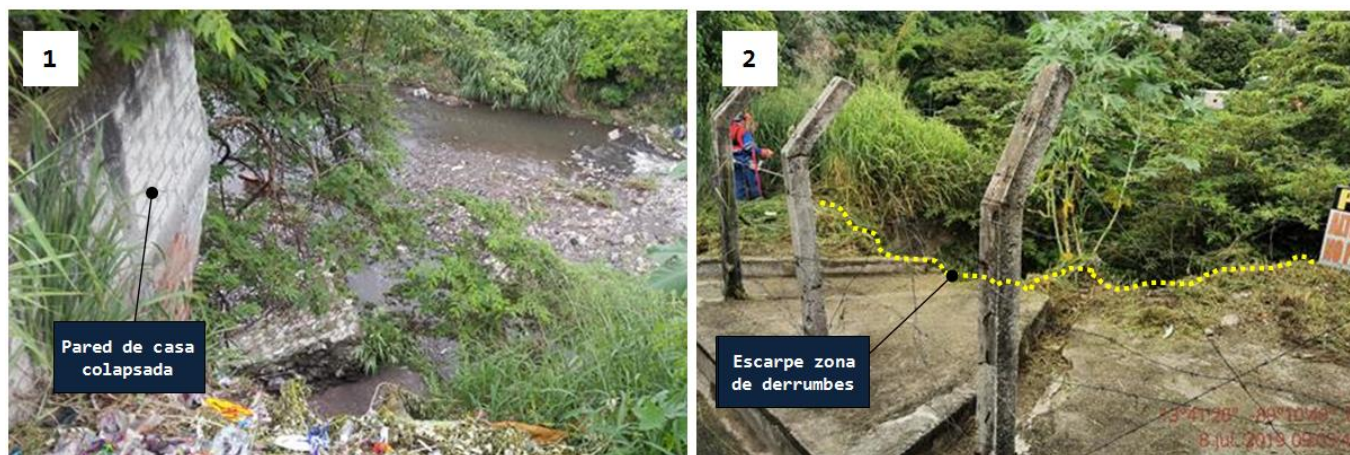
Figura 3. Sectores de comunidad contiguos a margen derecha de Río Acelhuate, afectados por derrumbes. [1] Vestigios de viviendas colapsadas; [2] Ubicación de antiguas viviendas colapsadas, contiguo a pasaje principal de la comunidad.
