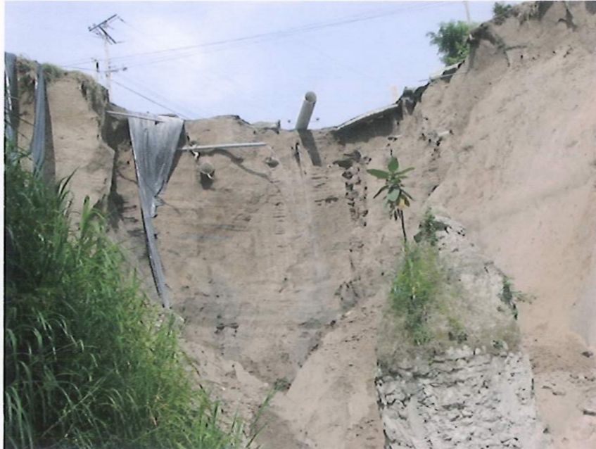
Fotografía 1. Talud en la zona de la cárcava, conformado por estratos de suelo tipificados como Arenas limosas (SM). Fecha: 29 de agosto de 2008.
