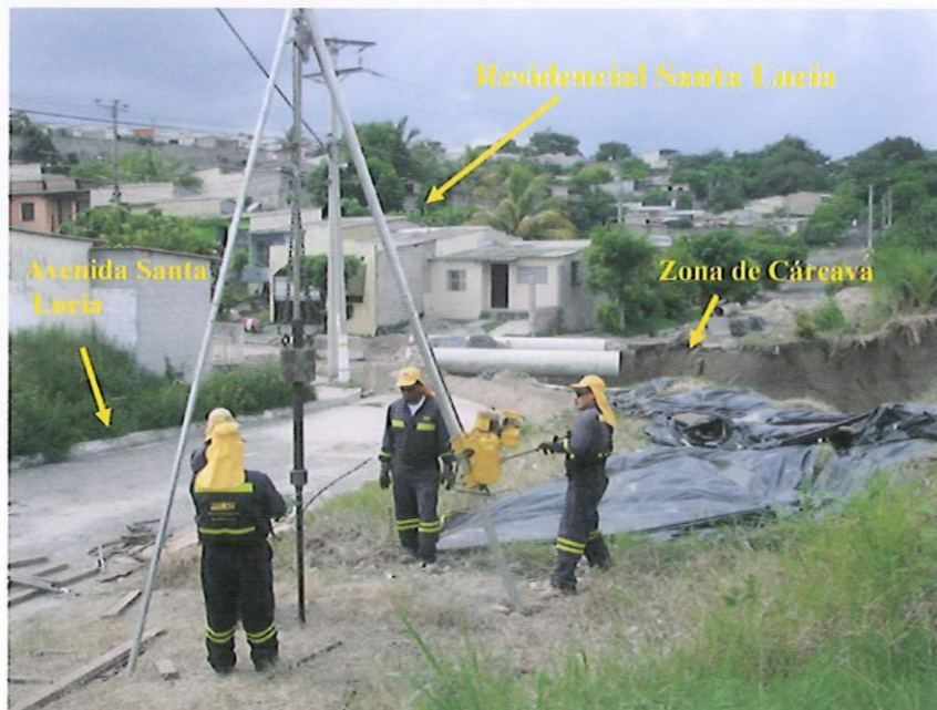
Fotografía 2. Personal de la UIDV-VMOP, realizando SPT 1, en la corona del talud, al costado Sur de la cárcava. Fecha: 29 de agosto de 2008.
